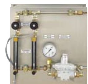
Pannello del gas
