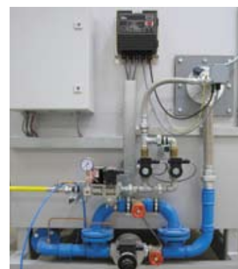
Sistema di riscaldamento a gas
