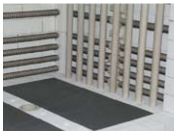
Immissione dell'aria preriscaldata mediante tubi di ceramica perforati
