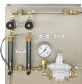
Pannello del gas
