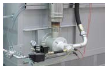
Alimentazione gas sul lato del forno
