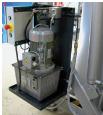
Gruppo idraulico con fluido idraulico incombustibile
