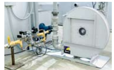
Bruciatore a gas con ventola per un preriscaldamento dell'aria
