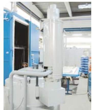
Scambiatore di calore nel canale di scarico gas
