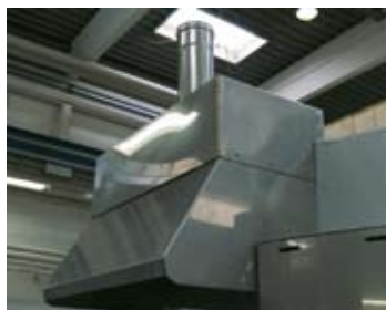
Cappa di aspirazione aria sull'apertura di caricamento
