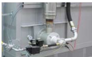
Alimentazione gas sul lato del forno
