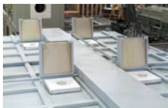
Valvole di scarico dell'aria ad azionamento automatico
