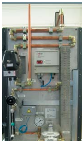
Impianto complesso di erogazione del gas
