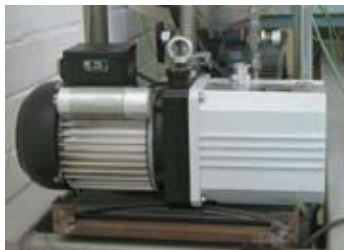
Pompa per vuoto per evacuazione a freddo della storta
